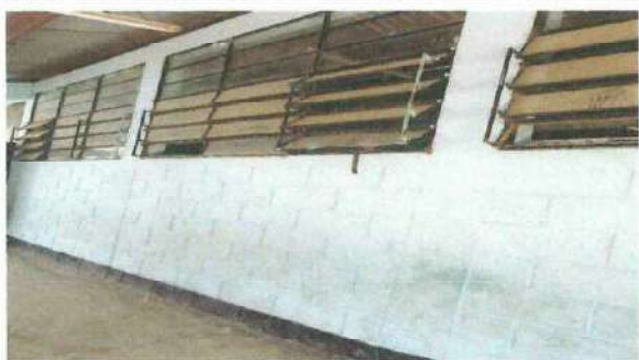
Foto 5: Se observa la pared deteriorada y falta de pintura. Módulo 2
