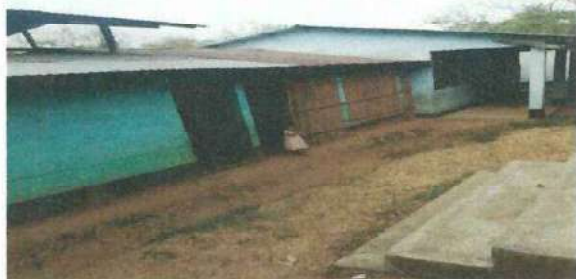
Foto 3: Se observa el aula de taniles y techo en mal estado. Módulo 3
