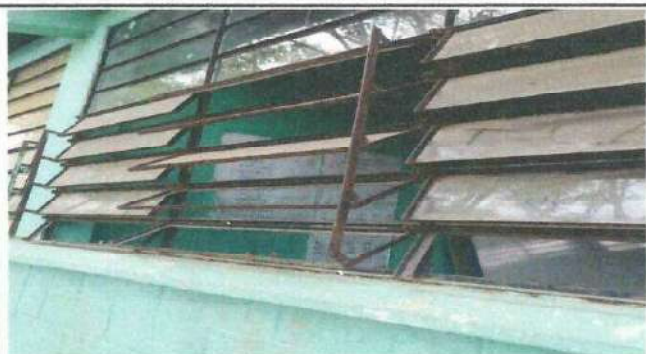
Foto 1: Se observa la cantidad de vidrios quebrados. Módulo 1
