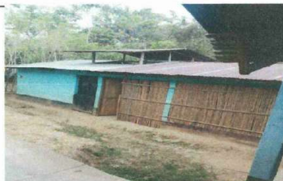
Foto 4: Se observa que el aula no esta circulada correctamente. Módulo 3
